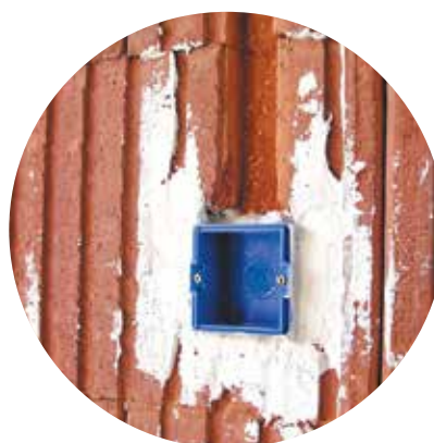
Boîtier électrique posé au plâtre
